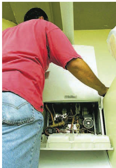
▲ Cambiare la caldaia
