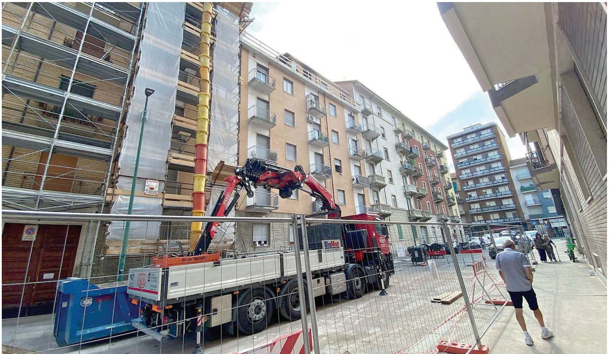
Via Nizza 389, quartiere Millefonti: le transenne circondano il palazzo devastato dall'esplosione
