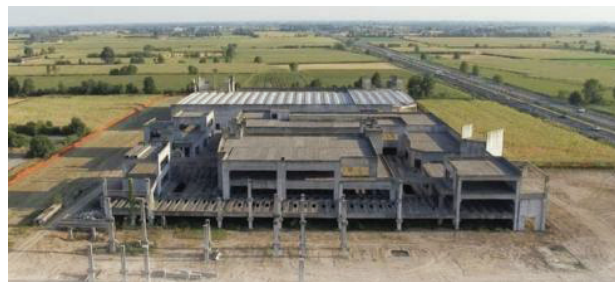
La cittadella dello shopping in stato di profondo degrado prima che venisse interamente rasa al suolo
