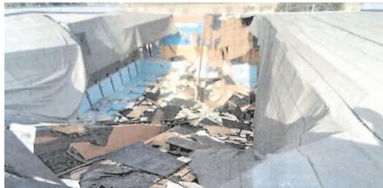
Il crollo del tetto della piscina comunale
