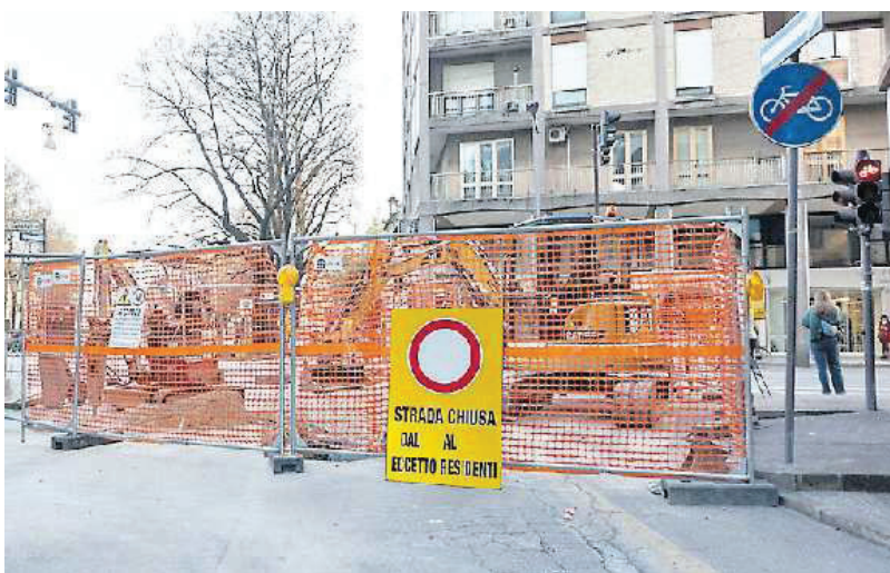
LAVORI IN CORSO I principali sono quelli legati alle nuove linee del tram
