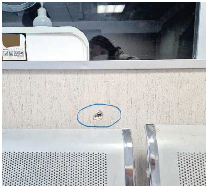
Il foro nel box della vigilanza, a lato sulla porta tagliafuoco
