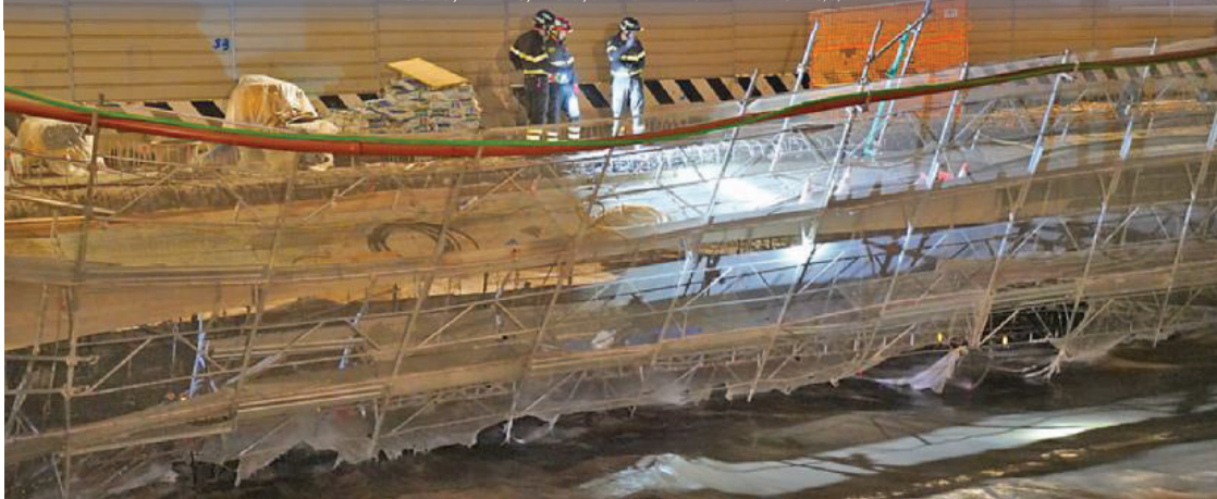
Ponte Nuovo a Verona | I vigili del fuoco osservano i danni ai ponteggi del cantiere causati dai tronchi trasportati ieri dalla piena dell'Adige
